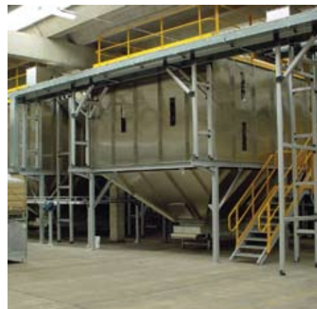
Silos para armazenamento de frascos
