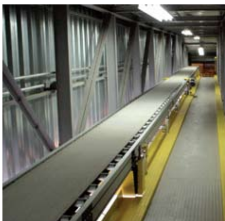
Transportador de correia sobre rolos
