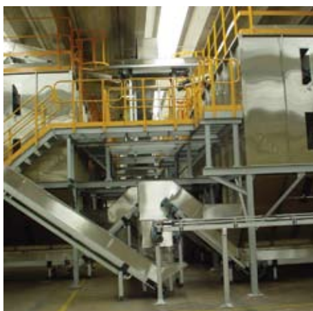
Silos para armazenamento e transporte de frascos
